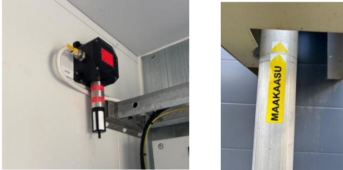
Kuva 4. Kaasunilmaisimien (vasemmalla) ja putkistomerkintä (oikealla).
