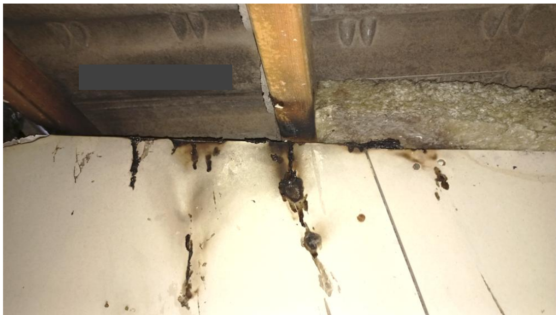
Kuva 4. Vesikatteen alapinnan epätiivetydet palo-osastoinnin kohdalla mahdollistavat palon leviämisen. (Kuva: Varsinais-Suomen pelastuslaitos)
