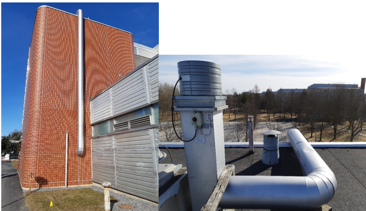
Kuva 5. Kemikaalitilojen poistoilman ulospuhallus järjestettynä uimahallin katolle.
