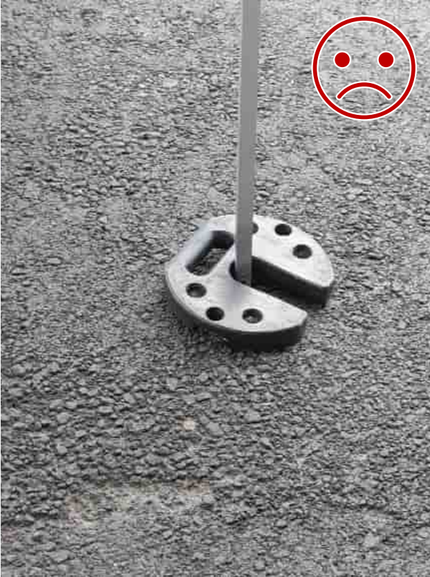
Kuva 3 EI NÄIN. Painoa ei ole lukittu rakenteeseen. Toinen paino päälle toiselta puolelta sekä painojen lukitseminen myös toisiinsa on tarpeen.
