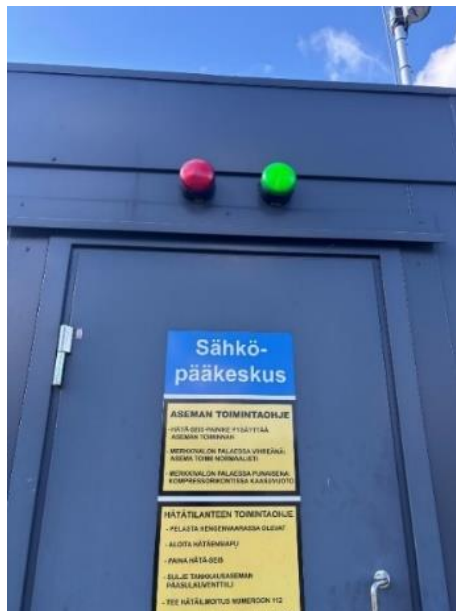
Bild 5. Varningslampor för gasläckage.
