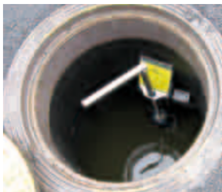
Öljynerottimen öljytilan täyttymishälyttimen anturi nostettuna ylös järjestelmän toiminnan tarkastusta varten.
