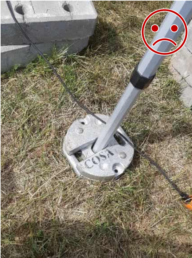
Bild 1 INTE SÅ HÄR. Lösning av vikterna vid varandra saknas. Vikterna lossnar med tyngdkraften och hålls inte runt stolpen när vinden skakar tältet.
