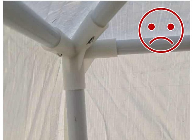
Bild 13 INTE SÅ HÄR. Konstruktion avsedd för konsumentbruk. Rören låser sig inte vid anslutningen.
