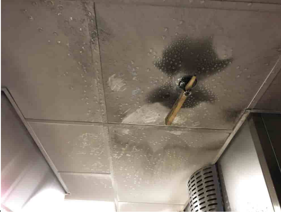
Tapaus10: Palokunnan asettama kiila lauenneeseen suuttimeen
